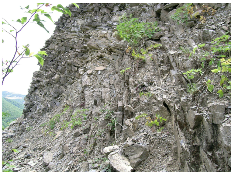
Figura 13: la fotografia evidenzia particolarmente bene i fenomeni di toppling diffuso e la scarsa qualità dell'ammasso roccioso.
