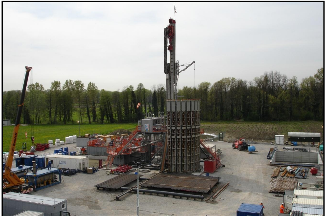
Figura 3.3.3a Esempio di Impianto di Perforazione con Potenzialità 3.000 m
