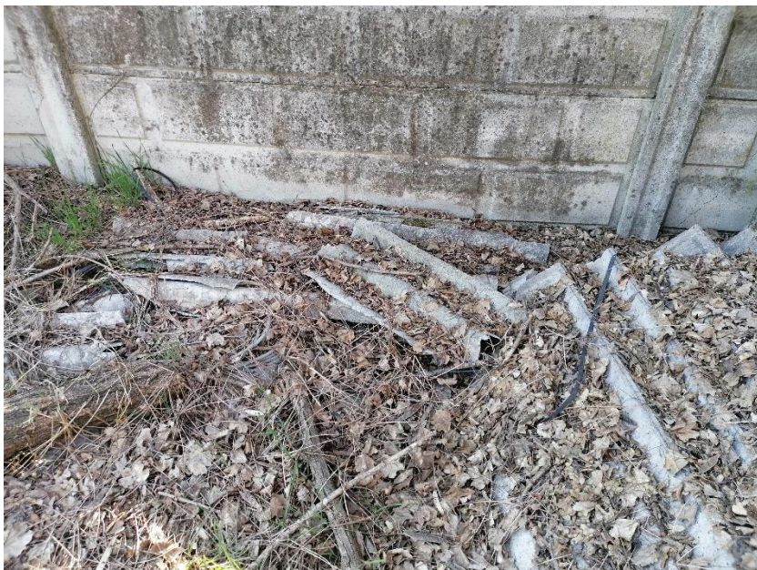
Lastre in fibrocemento potenzialmente contenenti amianto.
