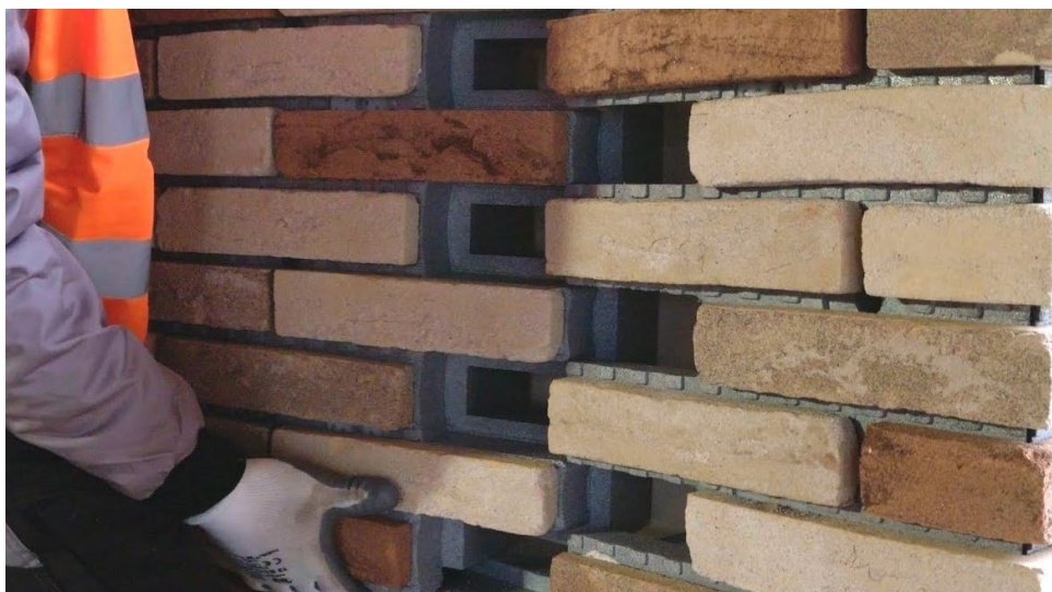
Figura 17 – Cappotto prefabbricato con finitura in mattoni faccia a vista
