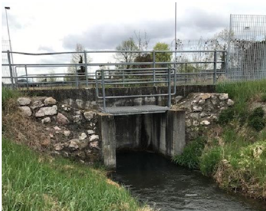
Figura 5 – Botte a sifone IN14 – IN15 esistente – Vista da valle sull'IN14.
