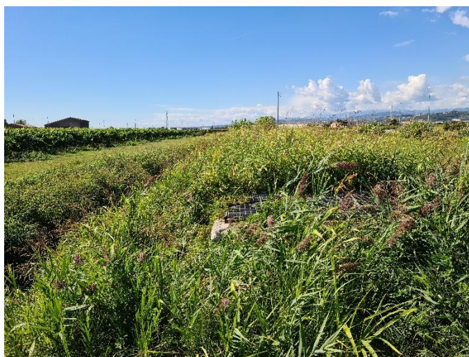
Vista di un pozzetto di ispezione nel tratto intubato del Canale Maestro
