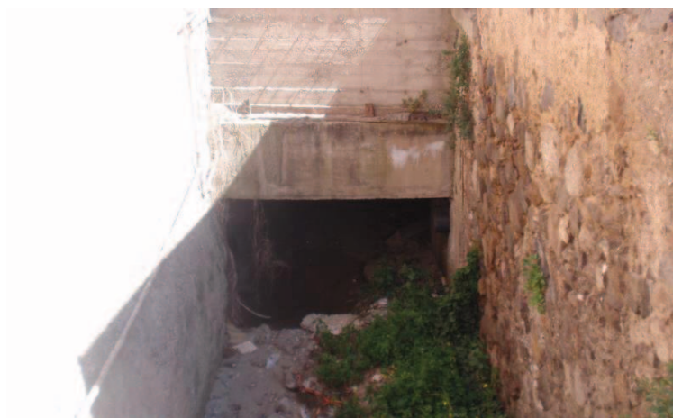
Figura 5: tombinamento al di sotto della ferrovia
