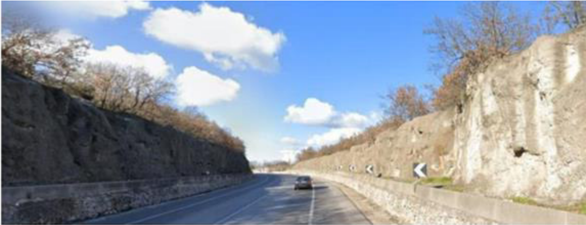
Foto 3 – Tratto SS100 esistente in trincea in corrispondenza attraversamento aree a Bosco e di previsione del cavalcavia di progetto per innesto alla complanare est esistente (Fonte Google Maps)
