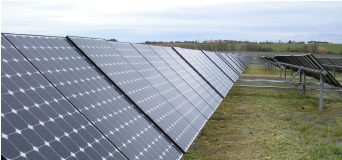
Figura 17 - Stato del terreno inerbito sotto i pannelli fotovoltaici
