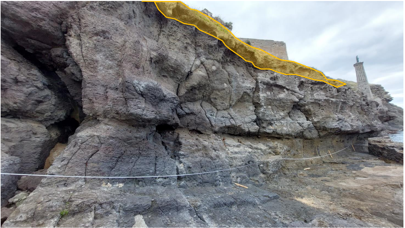
Figura 116 - Scalo Marinella: orlo della falesia/1. Tratti in aggetto sede potenziale di instabilità per caduta terriccio, pietre e crolli localizzati.
