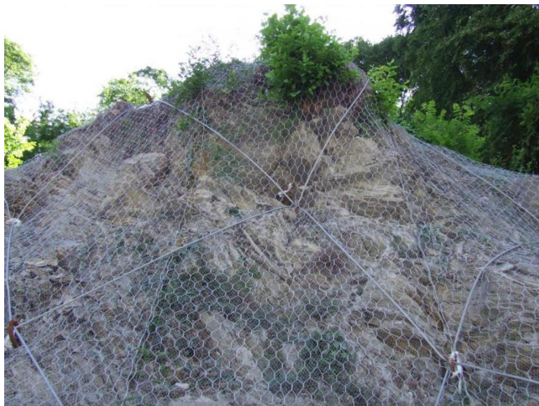
Figura 123 - Esempio di intervento con rete a maglia esagonale a doppia torsione con cavi in acciaio.
