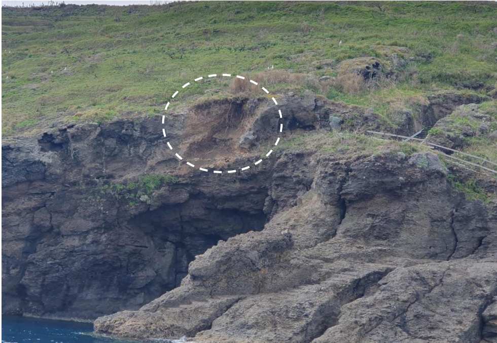
Figura 80 - Foto della zona di distacco post evento (tratteggio bianco) avvenuto presso lo Scalo n.4.
