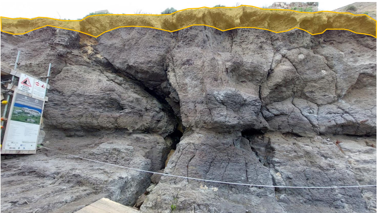
Figura 117 - Scalo Marinella: orlo della falesia/2. Tratti in aggetto sede potenziale di instabilità per caduta terriccio, pietre e crolli localizzati.
