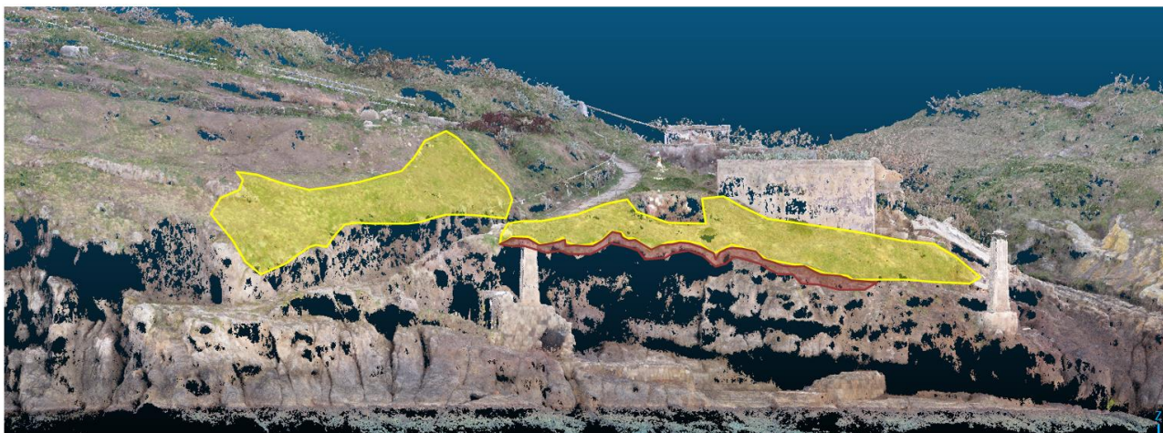
Figura 118 - Approdo Marinella. Criticità geomorfologiche: in giallo caduta di pietre e materiale terroso per dilavamento della coltre da parte delle acque meteoriche e/o per gravità; in rosso scuro crolli localizzati delle parti aggettanti lungo l'orlo superiore.
