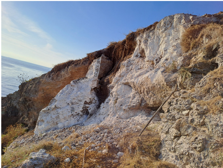
Foto 5: Post opera - Vista A dopo il primo disaggio effettuato con malte espansive
