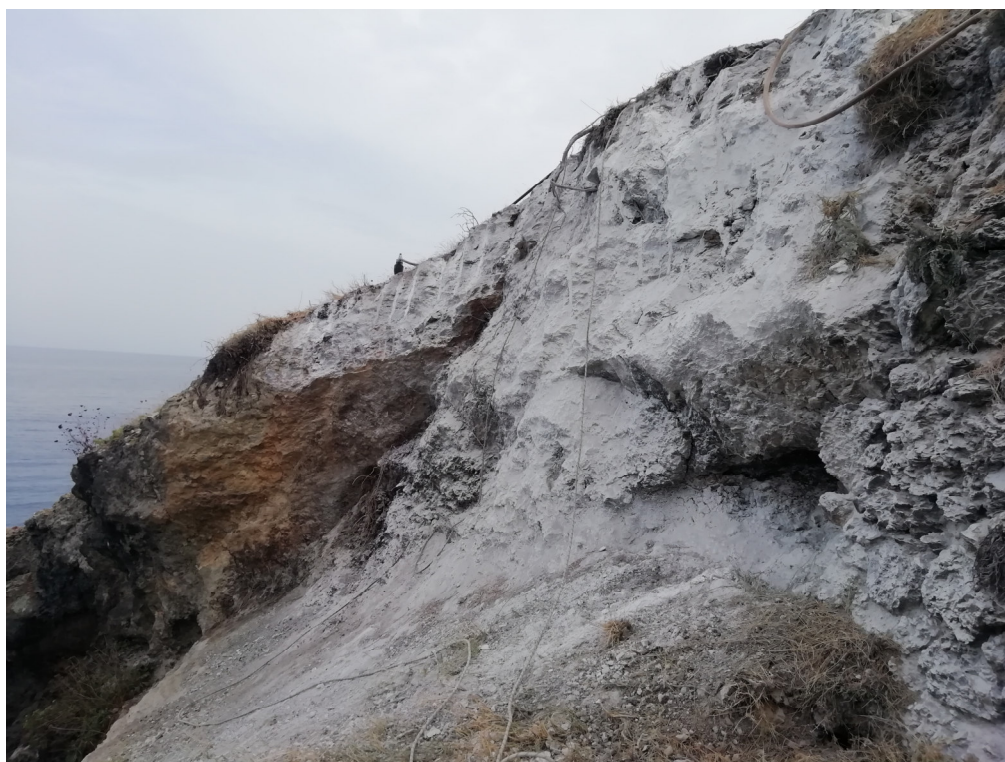
Foto 7: Post opera - Vista dopo il disgaggio del grande blocco individuato come instabile
