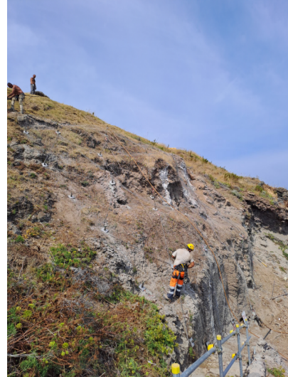
Figura 24: Creste aggettanti post opera
