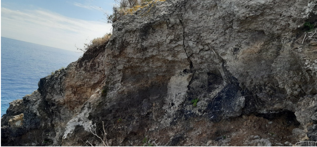
Foto 2: Ante opera - Vista A del blocco a rischio crollo
