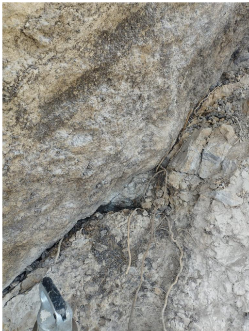
Foto 6: Particolare della frattura residua dopo il primo disgaggio
