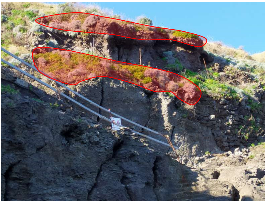
Foto 11: Ante opera - Aree sommitali della falesia costituite da fasce di alterazione aggettanti
