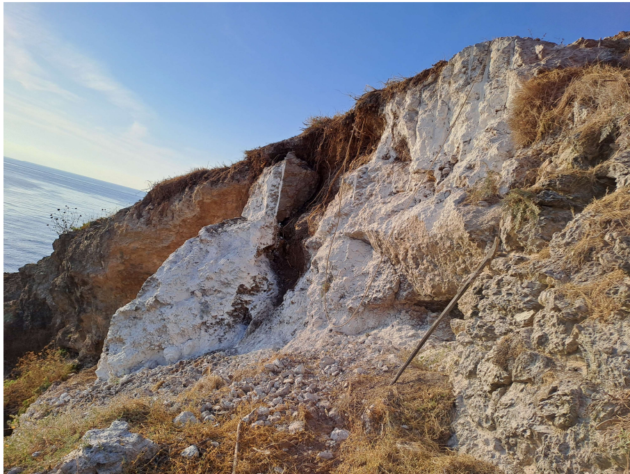
Fig. 19 - Post operam - Vista A dopo il primo disaggio effettuato con malte espansive
