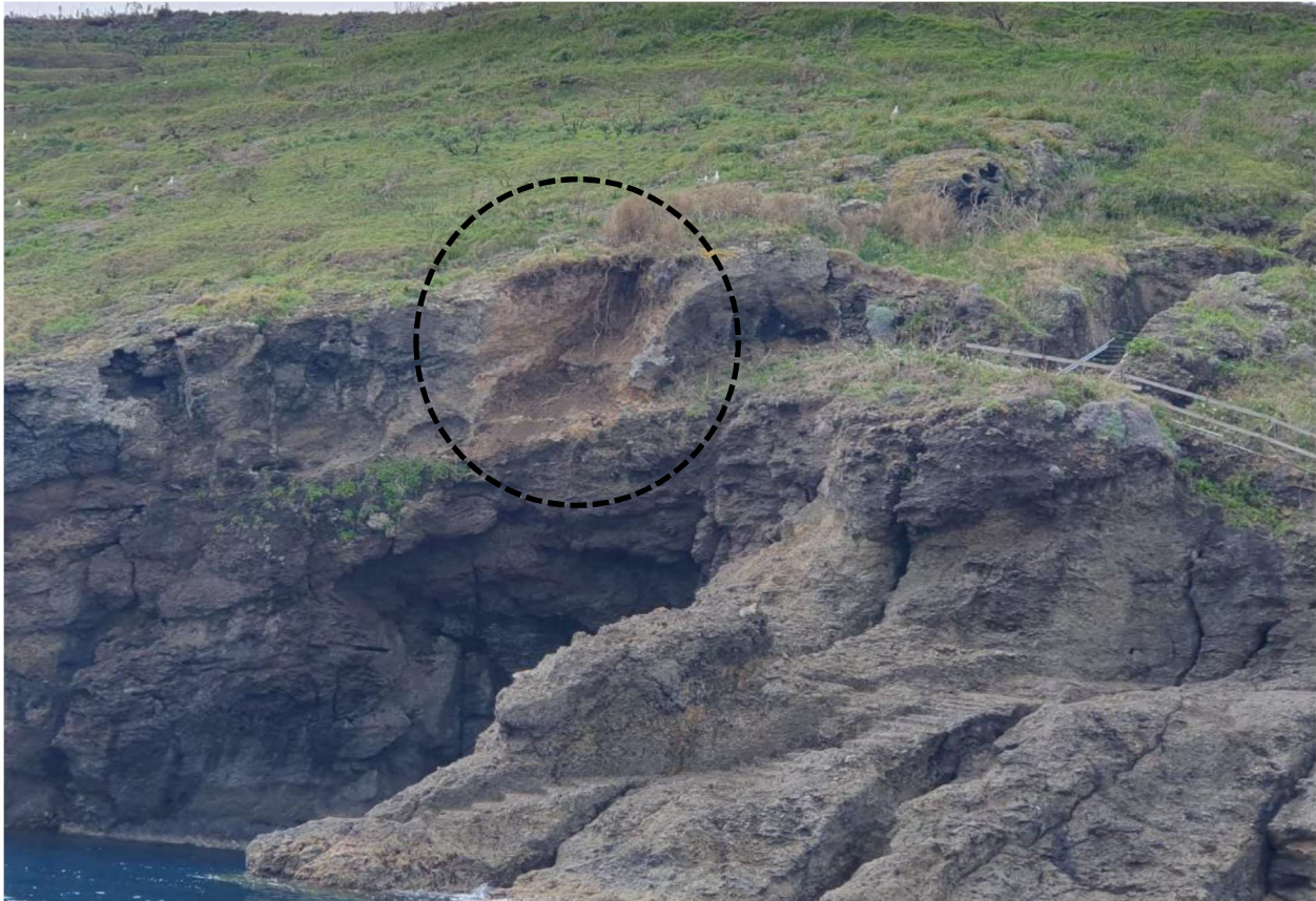
Fig. 9 - Foto della zona di distacco post evento (tratteggio bianco) avvenuto presso lo Scalo n.4.
