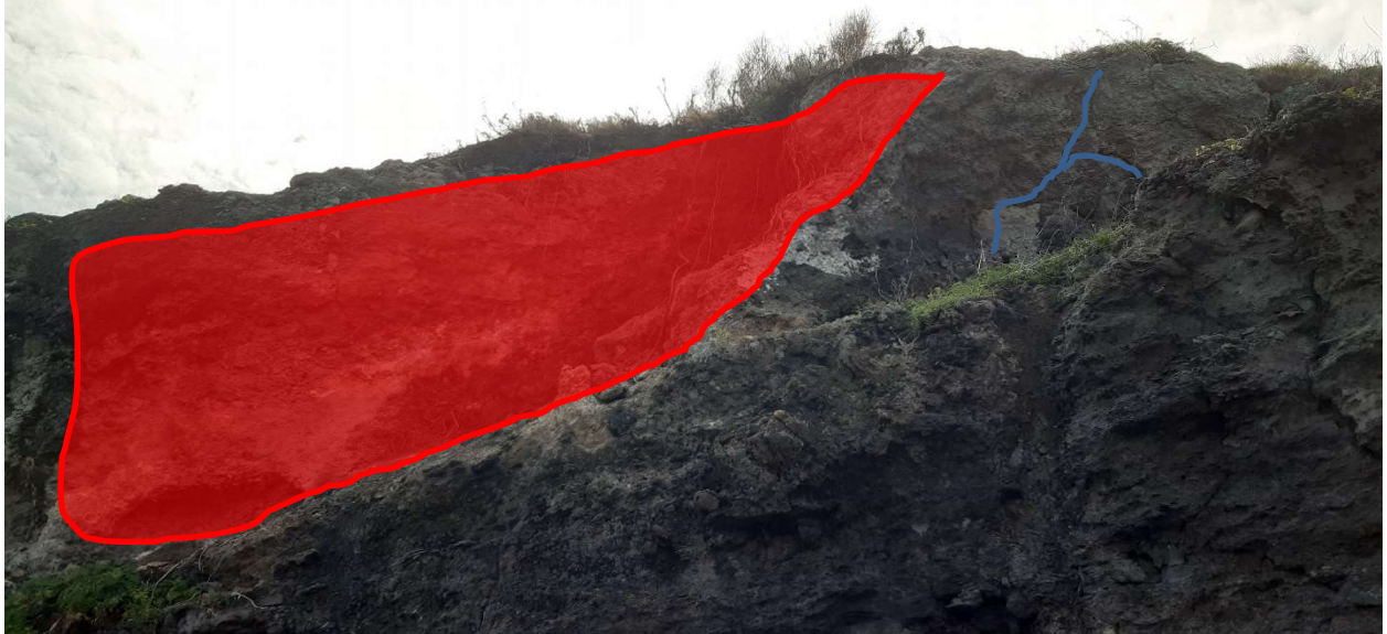
Fig. 18 - Ante operam - Vista B con evidenza delle fratture (blu) e della superficie di un precedente distacco (rosso)
