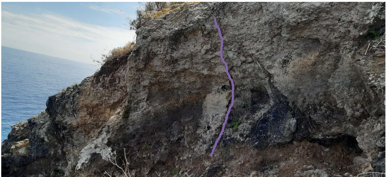
Fig. 17 - Ante operam - Vista A con evidenza delle fratture
