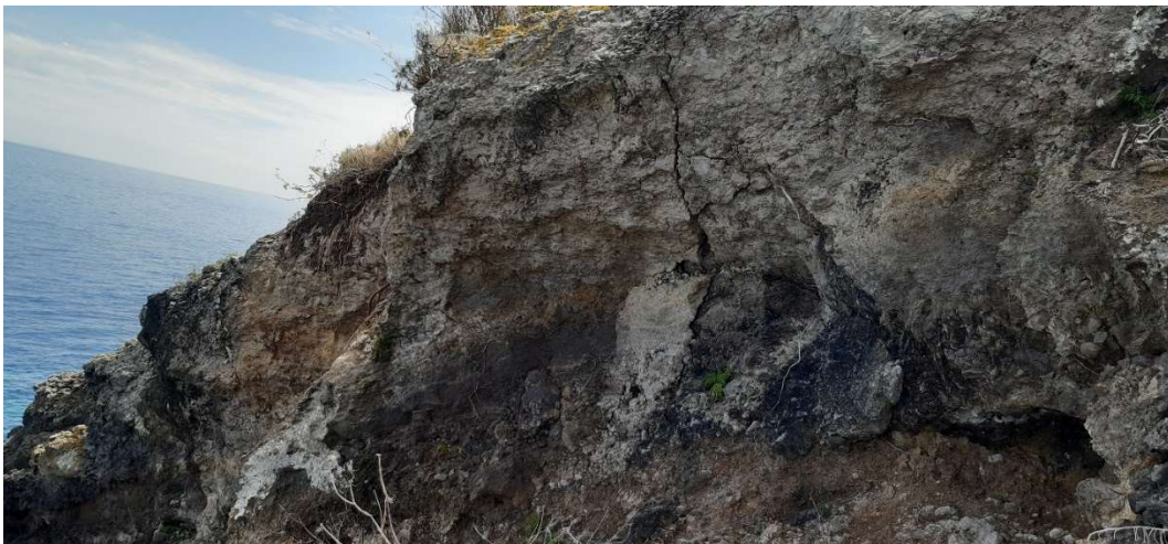
Fig. 16 - Ante operam - Vista A del blocco a rischio crollo
