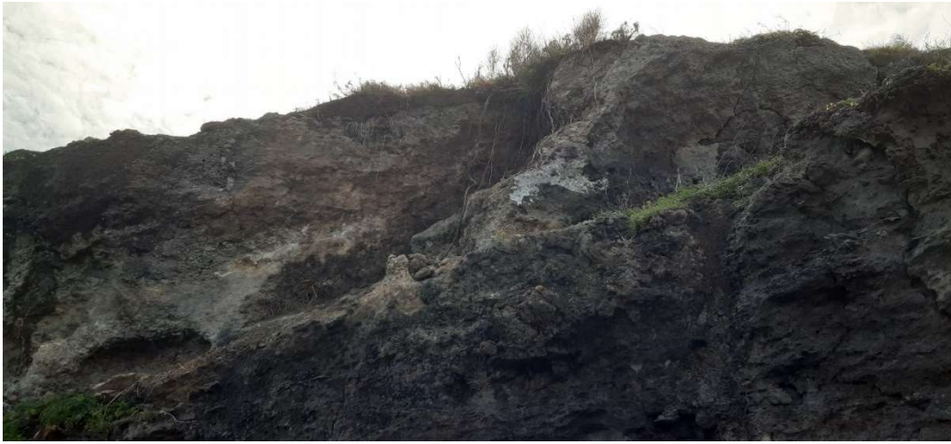
Fig. 15 - Ante operam - Vista B del blocco a rischio crollo
