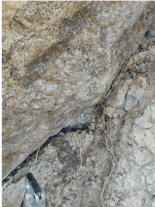
Fig. 20- Particolare della frattura residua dopo il primo disaggio
