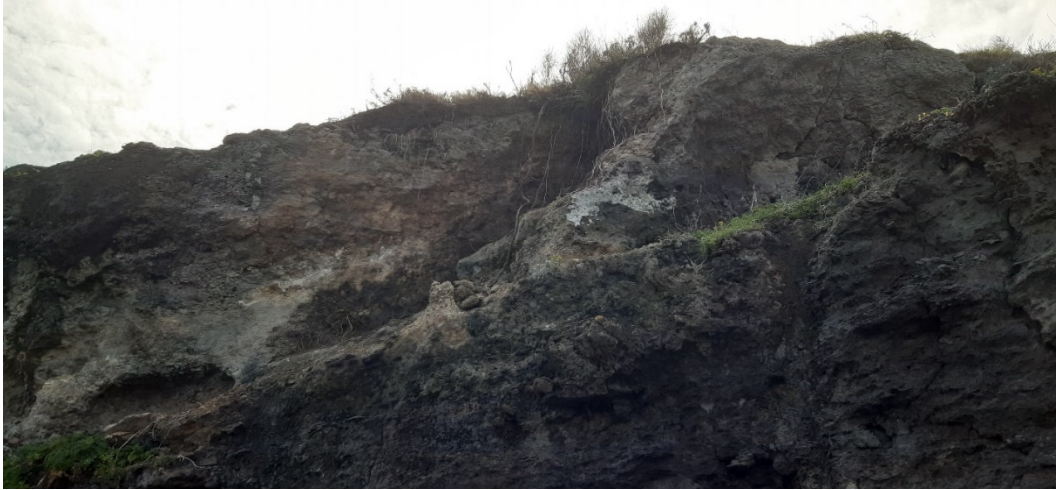
Foto 1: Ante opera - Vista B del blocco a rischio crollo
