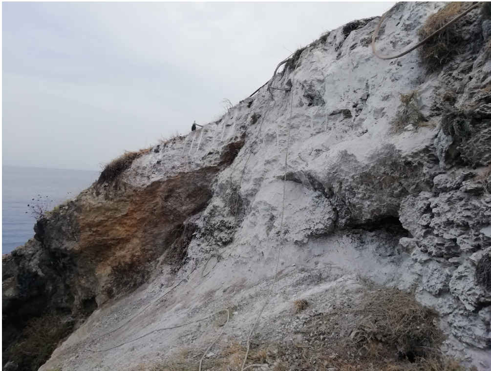
Foto 7: Post opera - Vista dopo il disaggio del grande blocco individuato come instabile
