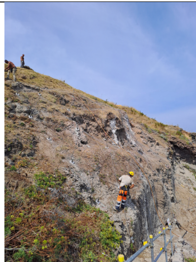
Figura 19: Creste aggettanti post opera
