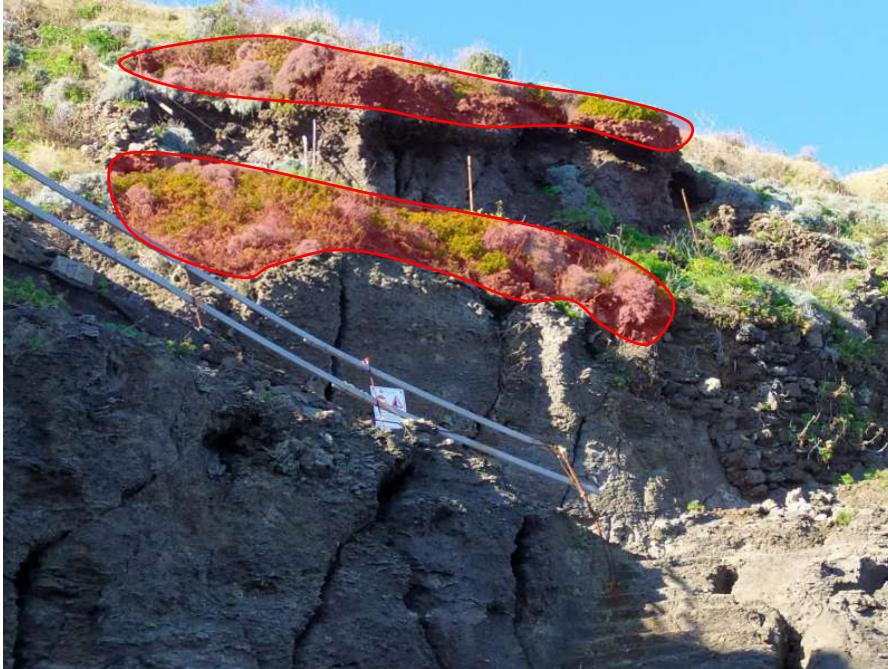
Foto 9: Ante opera - Aree sommitali della falesia costituite da fasce di alterazione aggettanti
