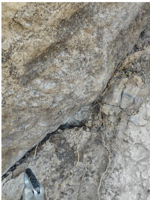
Foto 6: Particolare della frattura residua dopo il primo disaggio
