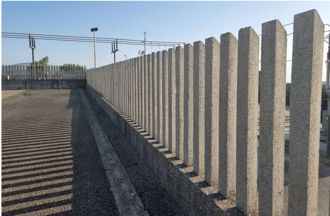
Fig. 4. Vista della SSE con particolare della recinzione SSE.
