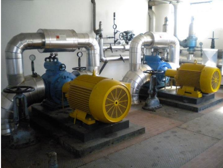
Figura 13: Pompe e tubazioni cabina travaso OCD in zona "S1"
