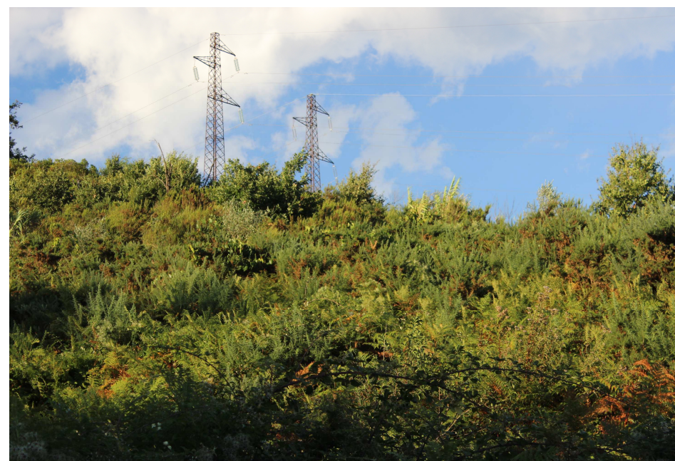
Foto 64: Sostegni delle Linee RFI 132kV esistenti, in prossimità dell'attraversamento con via di Balbano, nelle vicinanze dei sostegni n. 3 (380 kV) e n. 5 (132 kV ST).
