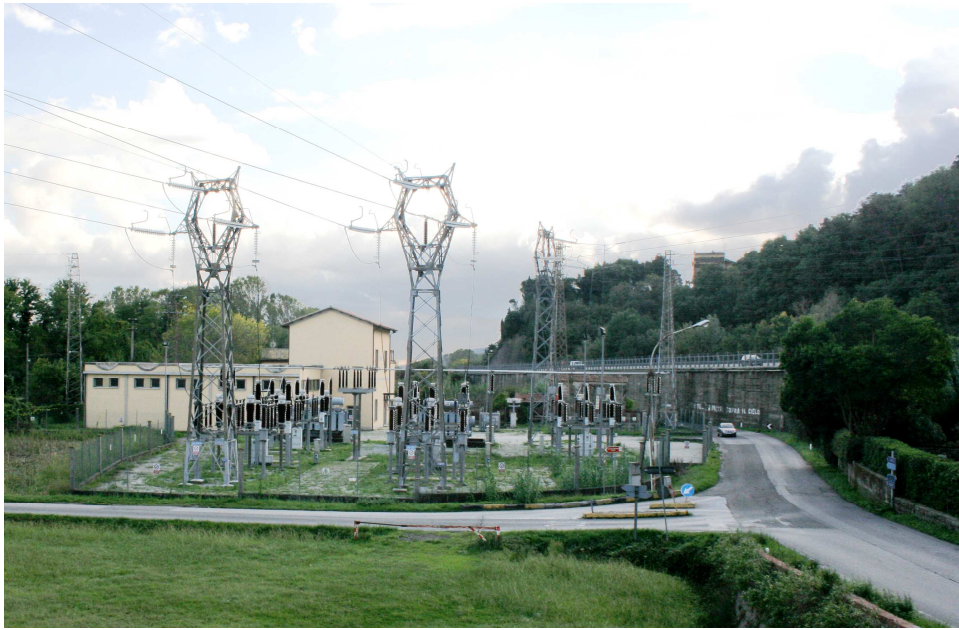
Foto 54: Vista della C.P. Filettole e della strada del Lungomonte Pisano. Il progetto prevede la demolizione del tracciato 132 kV in ingresso alla stazione.
