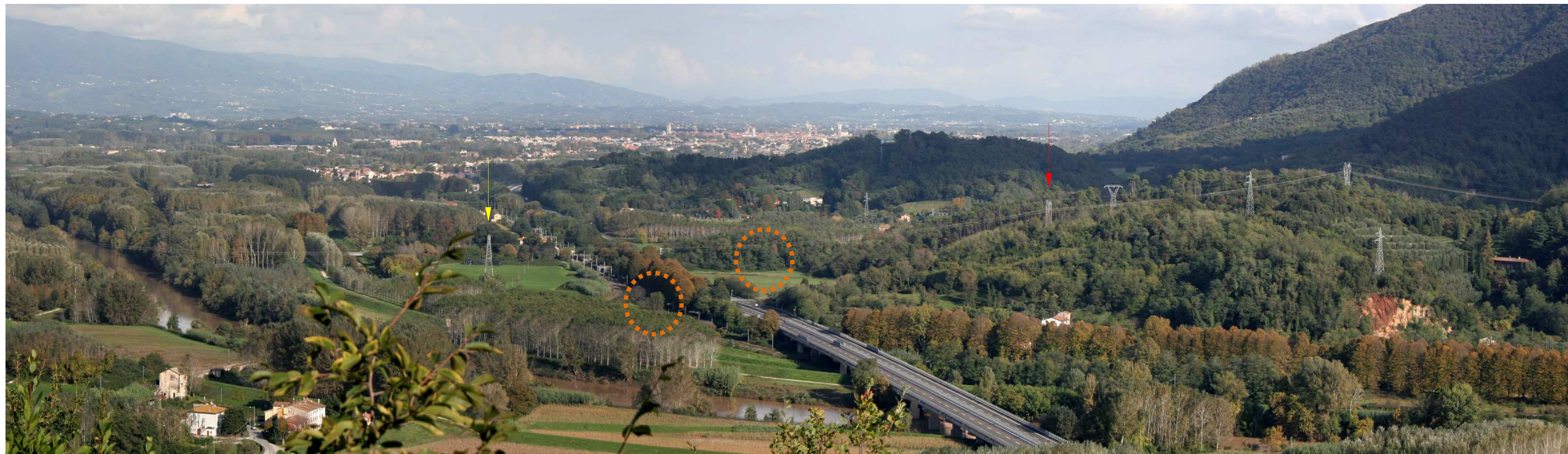
Foto 48: Dettaglio della foto n. 47. E' riconoscibile in primo piano il tracciato autostradale A11 Firenze Mare, nel punto di attraversamento del fiume Serchio. La freccia gialla indica il sostegno n. 121 della linea 380kV in demolizione. La freccia rossa indica il sostegno n. 122 della linea 380kV DT esistente, al quale si raccorda il tracciato in progetto. Le aree arancione indicano approssimativamente la posizione dei sostegni n. 10 e 11 della linea 380kV tratto sud in progetto.
