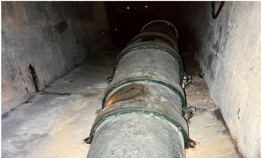
Foto A3 - Particolare ingresso seconda galleria con tubazione flangiata su blocco di ancoraggio.
