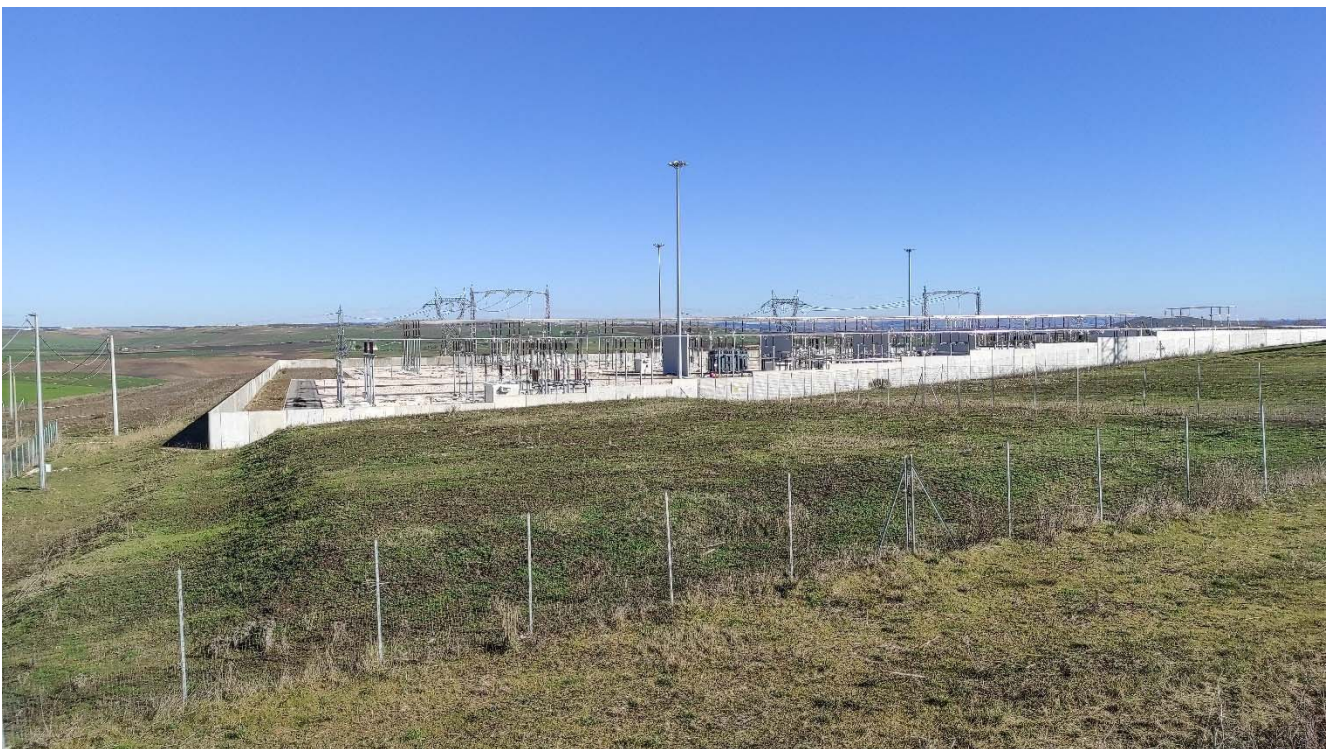
Stazione elettrica Terna esistente 380/150 kV “Genzano”
