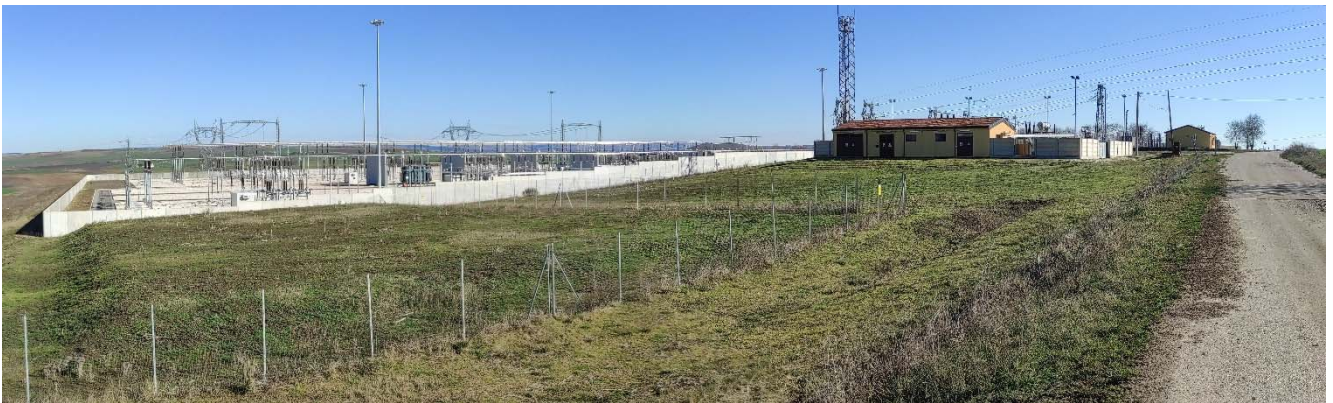
Stazione elettrica Terna esistente 380/150 kV "Genzano"
