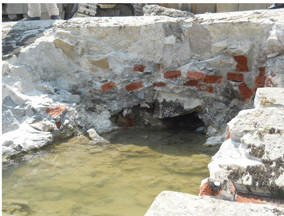
Figura 10: Dissesto del corpo originario della traversa
