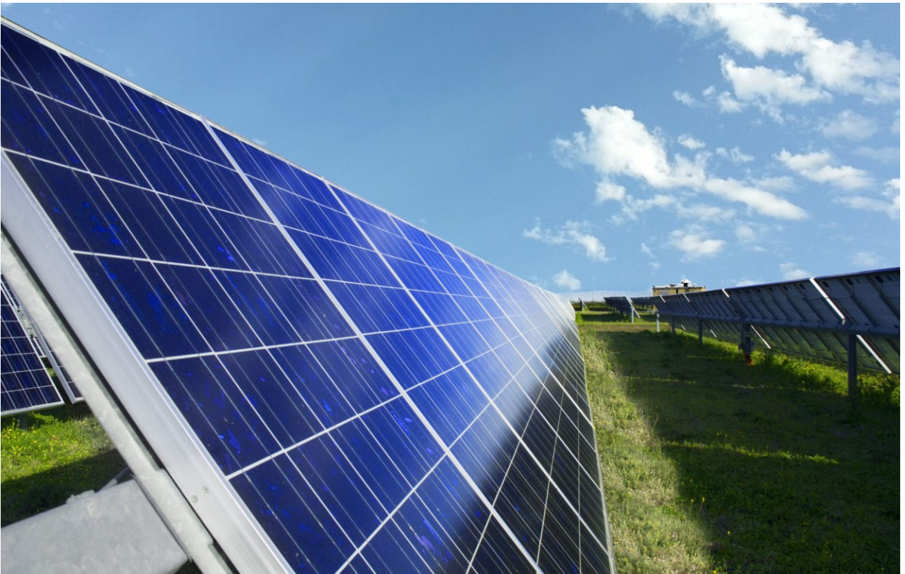
Figura 39 - particolare stringa fotovoltaica
