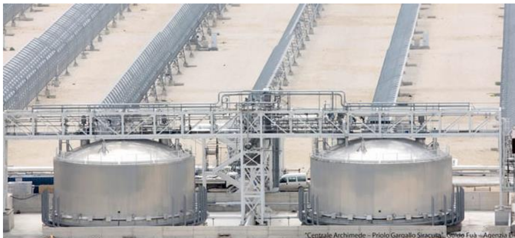
Figura 20. Serbatoi di Accumulo - Esempio
