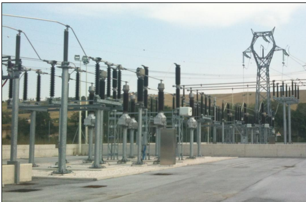
Figura 73: Esempio stallo in Stazione Elettrica
