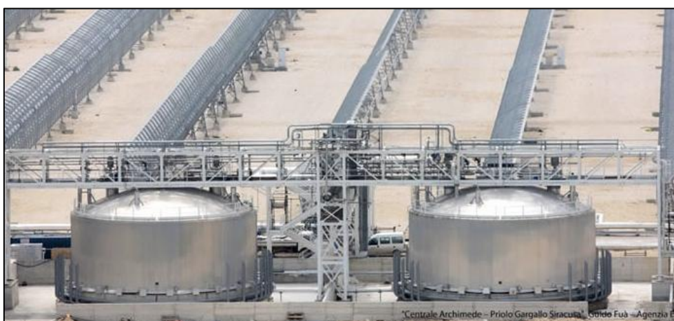
Figura 27: Serbatoi di Accumulo - Esempio
