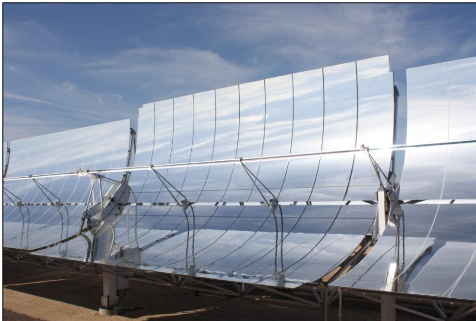
Figura 19: Collettore parabolico LAT 8.0 m - SCE
