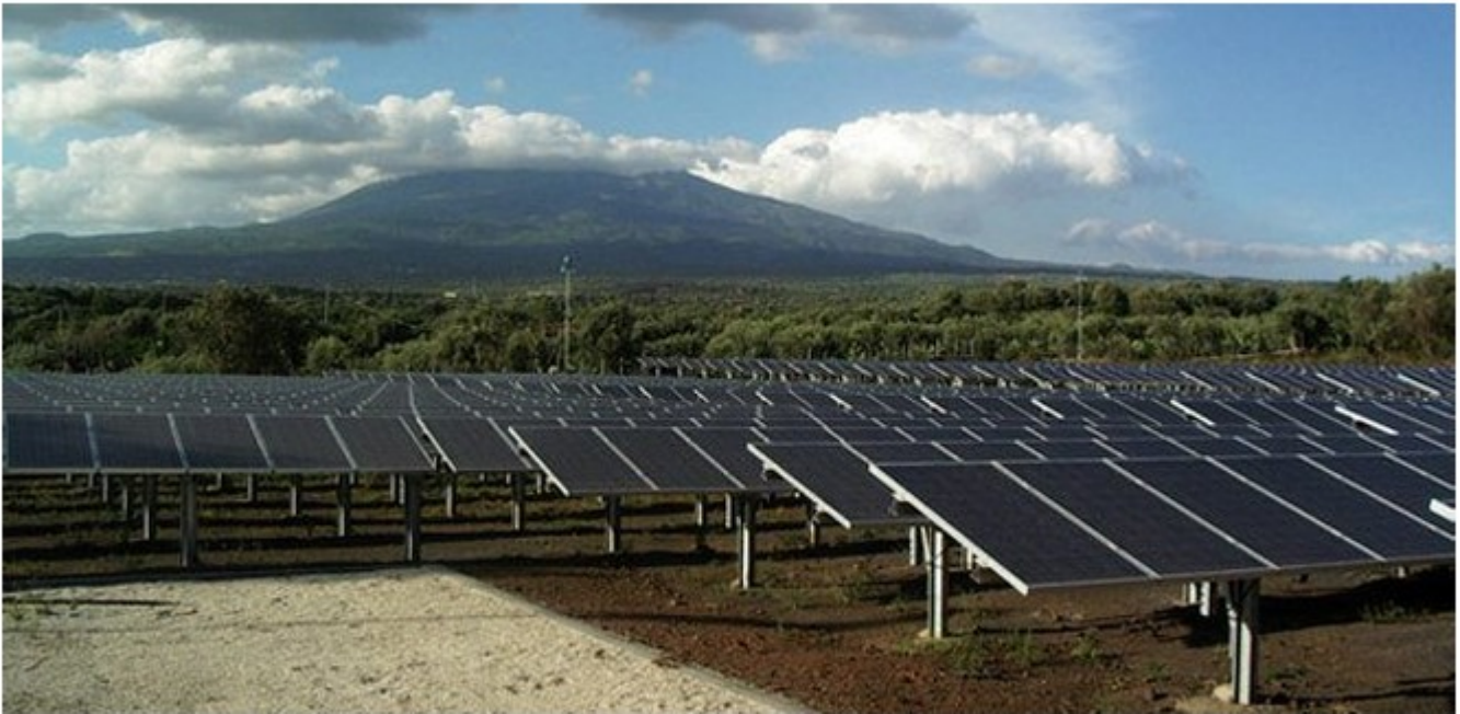
Figure 6-2 strutture fisse con pannelli
