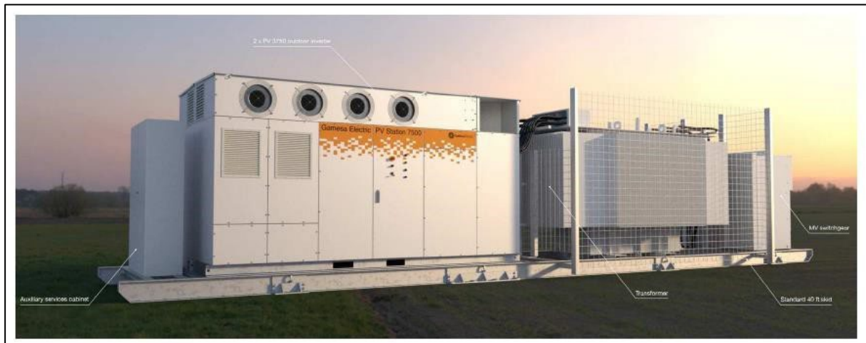
Figura 11 - ESEMPIO DI CABINA ELETTRICA (POWER STATION)
