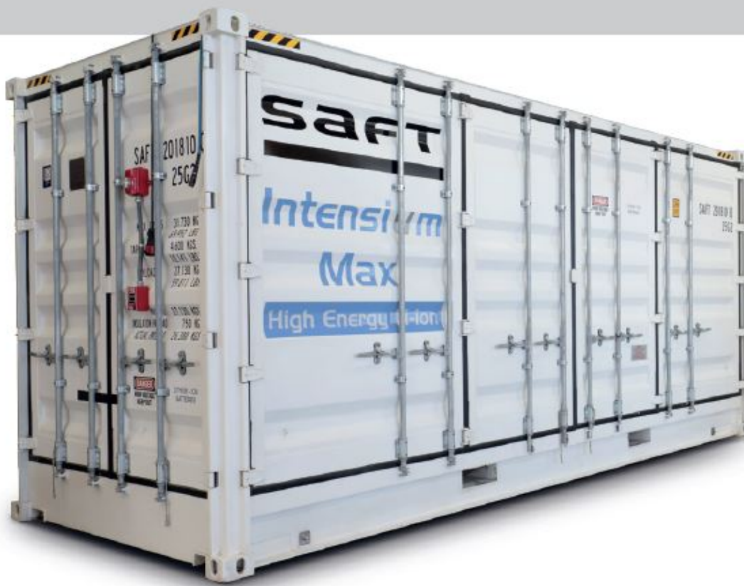
Figura 9 – Esempio container di accumulo del tipo 20ft e capacità 2,3 MWh
