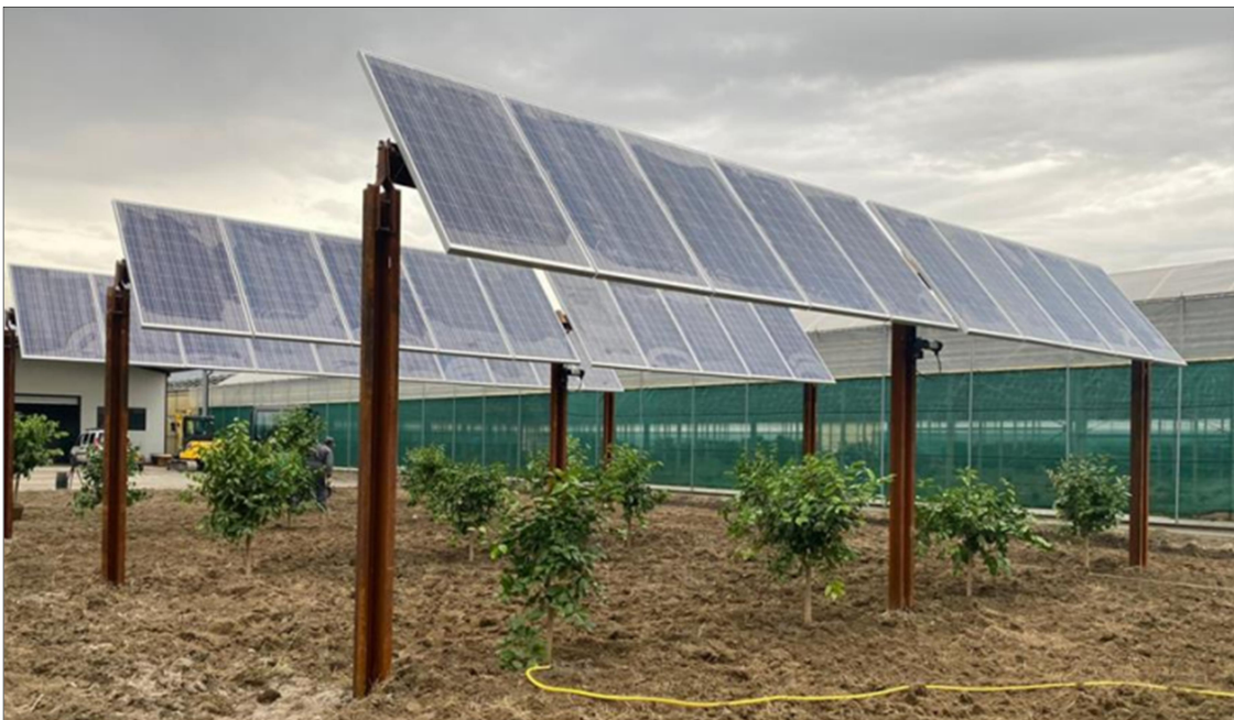
Figura 6 - Esempio strutture tracker utilizzate nell'impianto agrivoltaico
