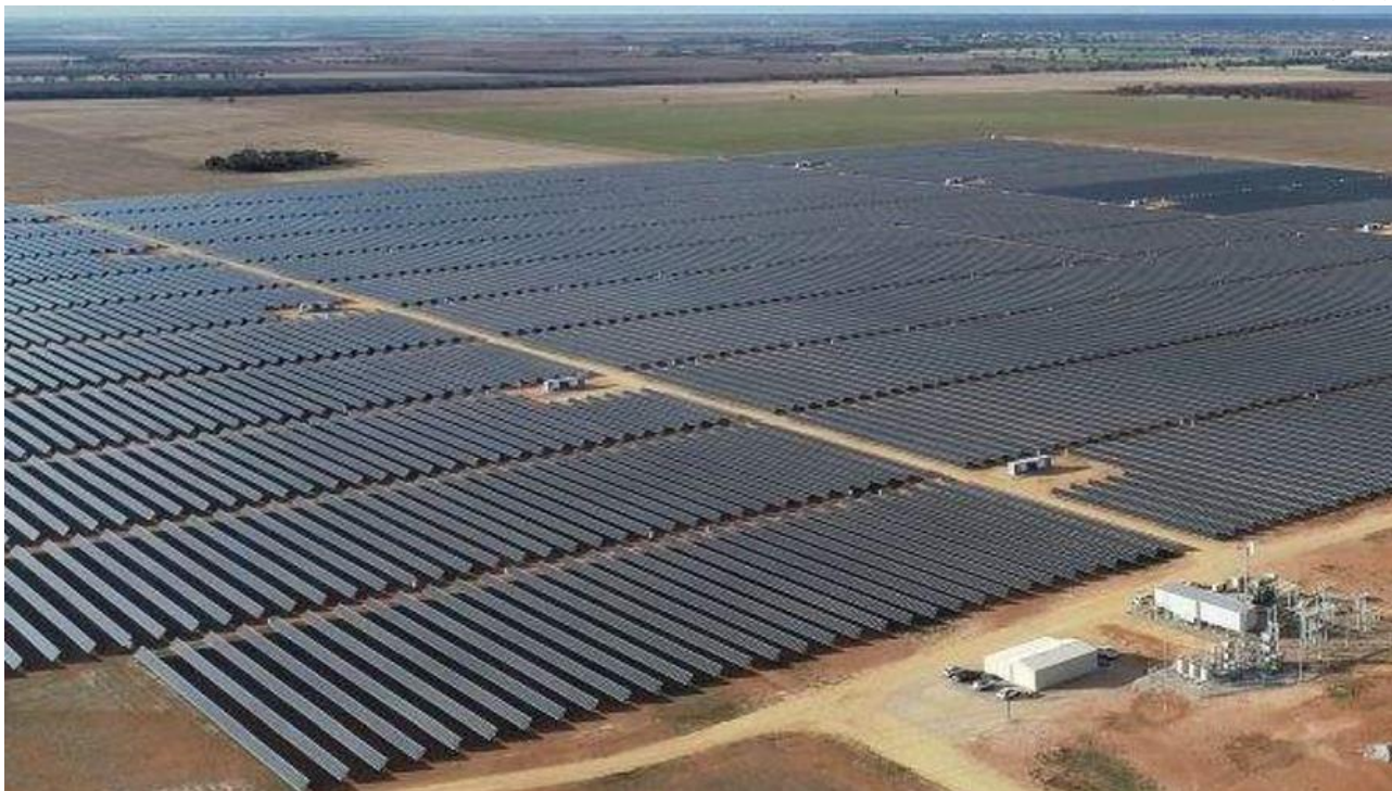
Figura 3.13: Esempio di impianto fotovoltaico installato su tracker monoassiali
