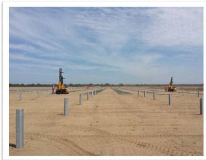
Figura 56 - Foto esempio di impianti realizzati con stessa struttura e stessi moduli fotovoltaici
