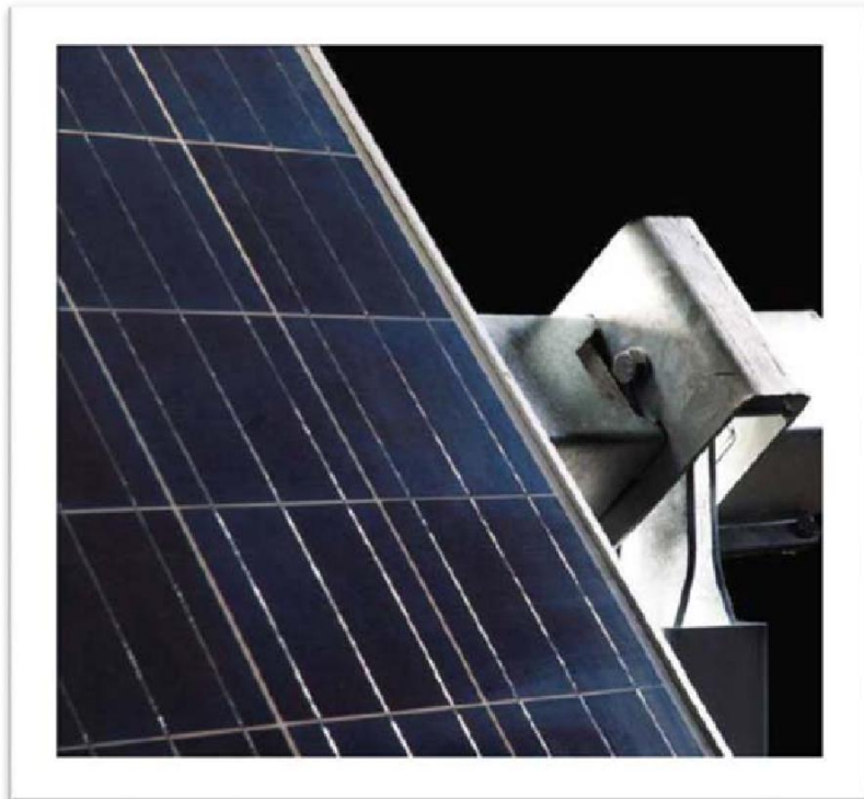
Figura 6.4. – Strutture di sostegno dei moduli fotovoltaici.
