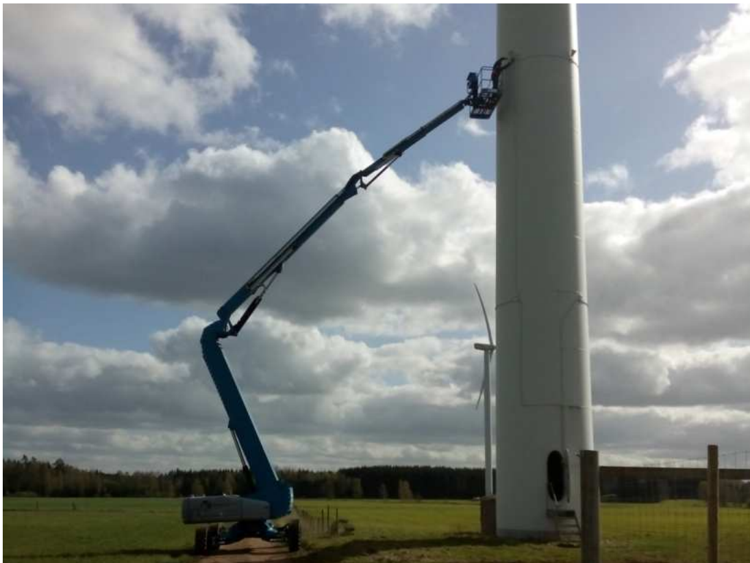
Figur 12. Montering av DTBird-systemet. Beroende på vilka vinklar som är viktigaste att filma och för att begränsa ljudspridningen kan man välja att installera högtalare och kameror på olika höjder. Foto: Tore Wizelius.
