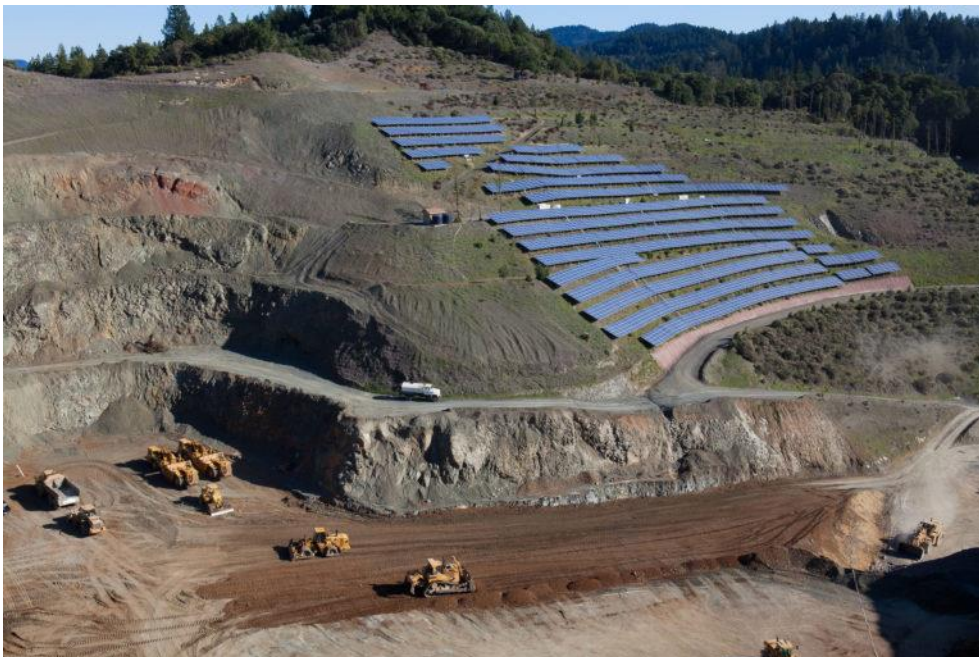
Esempio di moduli fotovoltaici su pareti a forte pendenza
