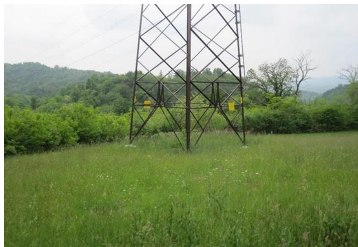
Figura 2.24: Esempio di intervento di inerbimento intorno al sostegno di una linea aerea
