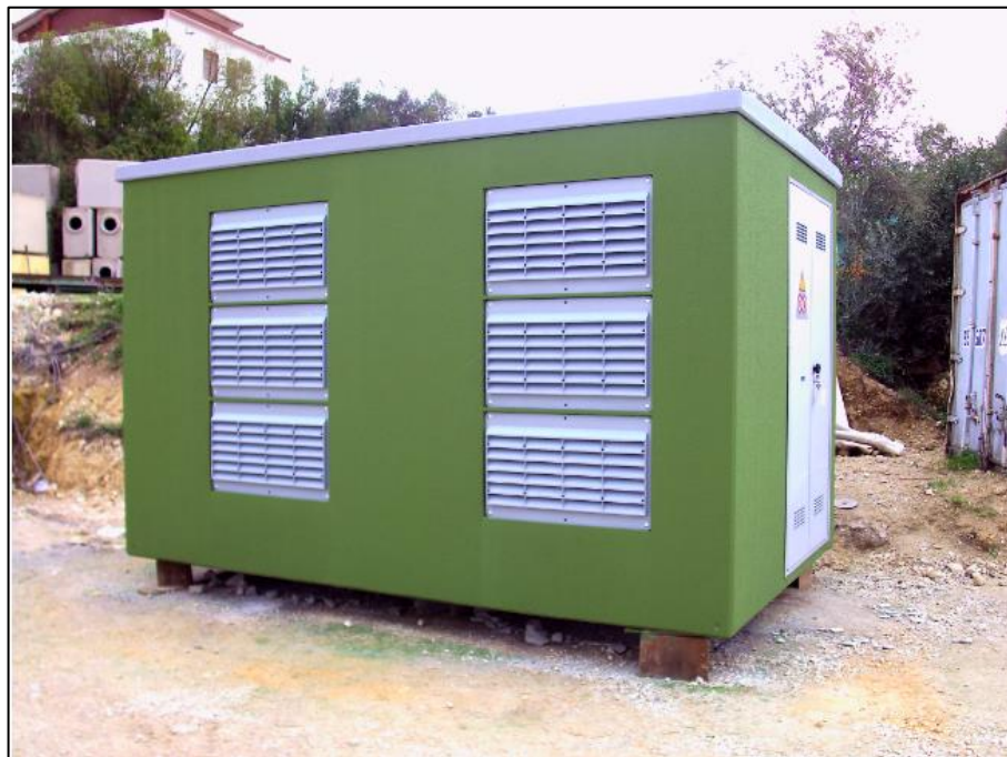
Tipico cabina elettrica prefabbricata
