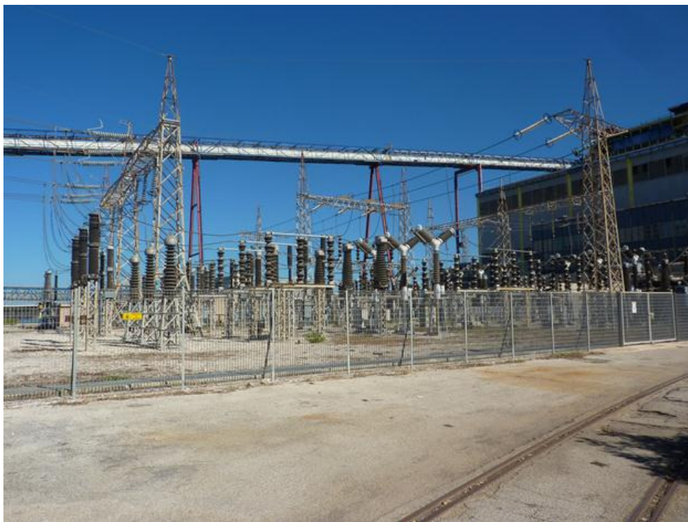
Figura 6 - Stazione elettrica 220 kV
