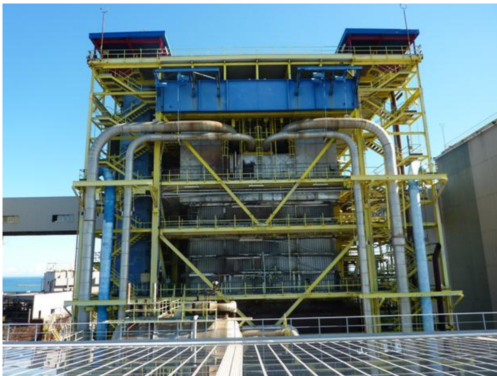
Figura 2 - Vista parziale della caldaia unità 2
