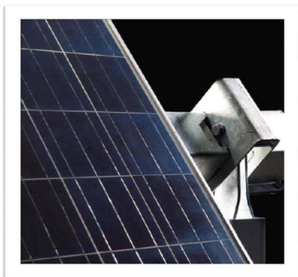
Figura 6.4. – Strutture di sostegno dei moduli fotovoltaici.
