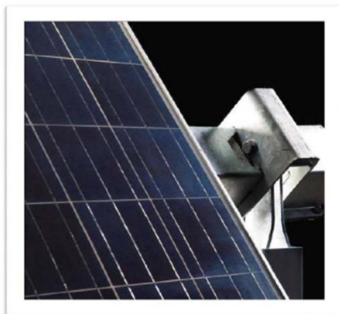
Figura 6.6. – Strutture di sostegno dei moduli fotovoltaici.
