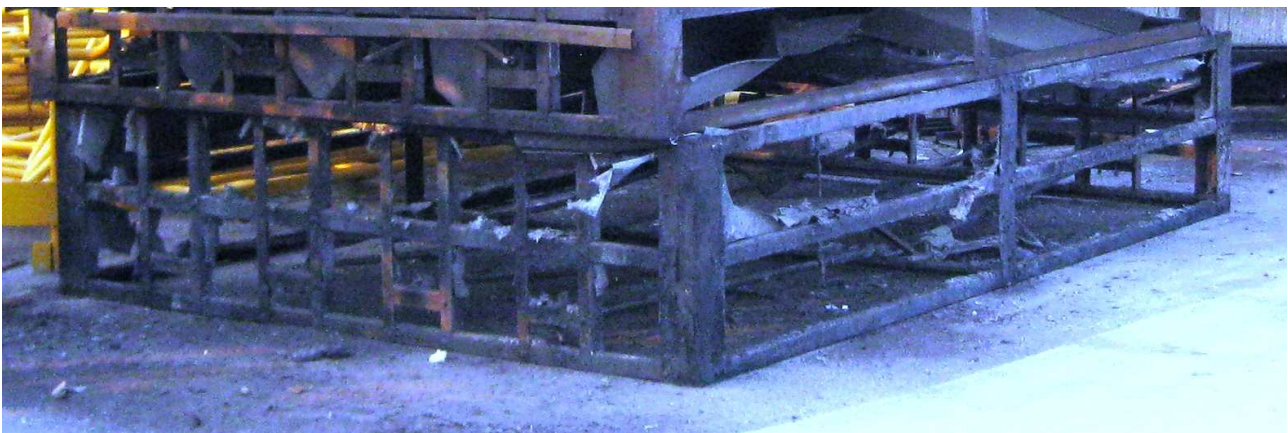
Aeratore EC rimosso in seguito ad incendio
