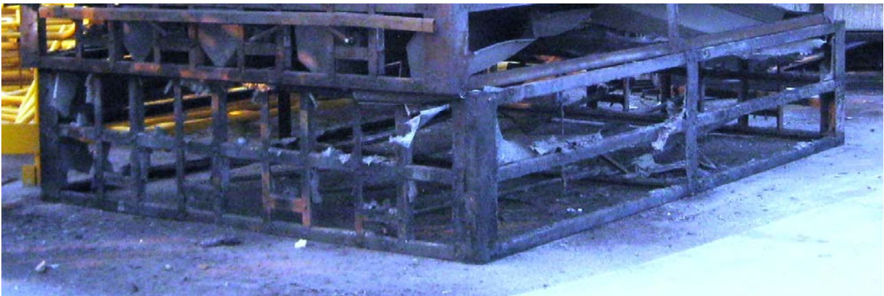
Aeratore EC rimosso in seguito ad incendio
