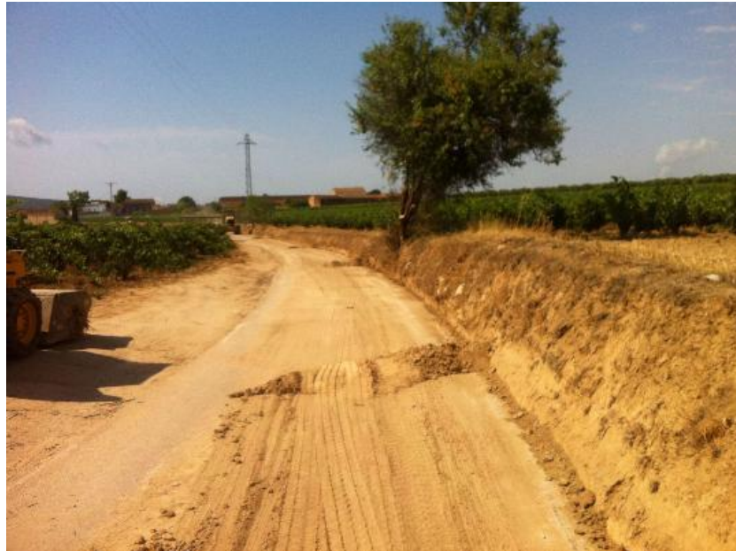
Figura 8- Esempio degli effetti del transito mezzi su strade non asfaltate
