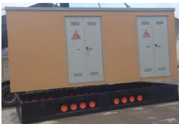
Figura 3-10 – tipologia delle cabine di sezionamento
