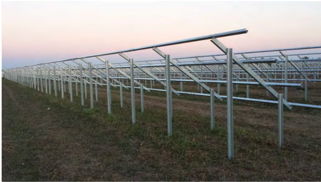
Figura 6 – Esempio di strutture di sostegno ai pannelli fotovoltaici.
