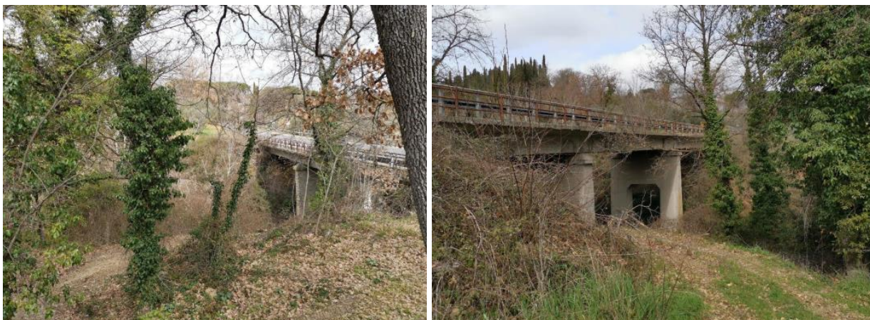
Figura 5: Situazione attuale. Pile centrali e impalcato viadotto (Fonte: Allegati alla Lista di controllo)
