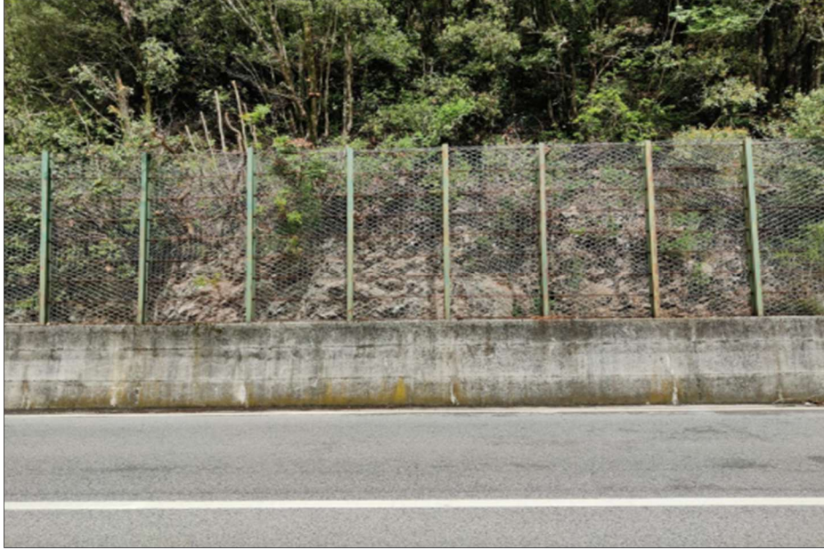
Figura 21 – Scaglia rossa fittamente tettonizzata, pk. 1+200 circa
