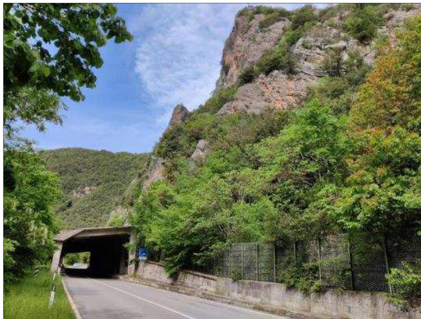
Figura 18 – Parete rocciosa costituita dalla Scaglia rossa (SAA) interessata dal crollo di blocchi lapidei e che ha comportato la realizzazione di protezione mediante costruzione di galleria artificiale.
