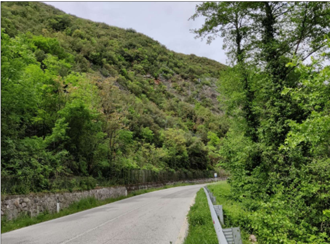
Figura 28 – Panoramica frana da crollo posta a monte delle pk 2+625-2+725 circa. Prevista la realizzazione di muro di controripa.
