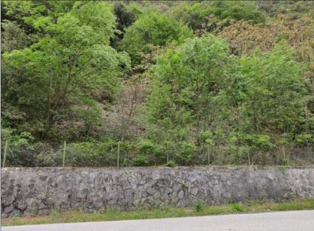
Figura 27 – Placca detritica centrata sulla pk 2+550; previsto intervento di protezione mediante la realizzazione di paratia di pali.
