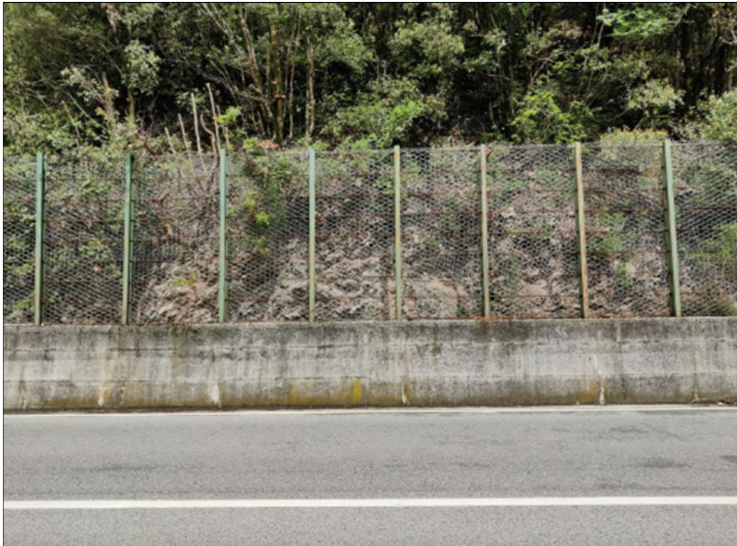
Figura 21 – Scaglia rossa fittamente tettonizzata, pk 1+200 circa
