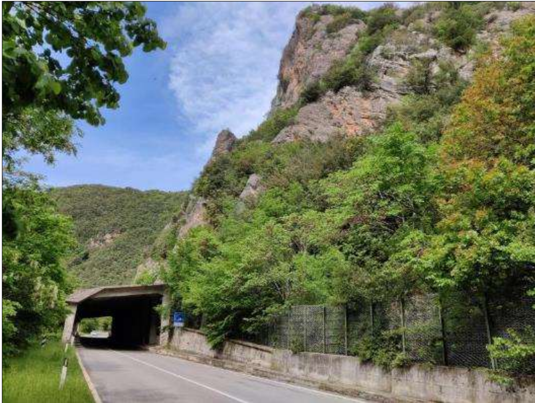
Figura 18 – Parete rocciosa costituita dalla Scaglia rossa (SAA) interessata dal crollo di blocchi lapidei e che ha comportato la realizzazione di protezione mediante costruzione di galleria artificiale.
