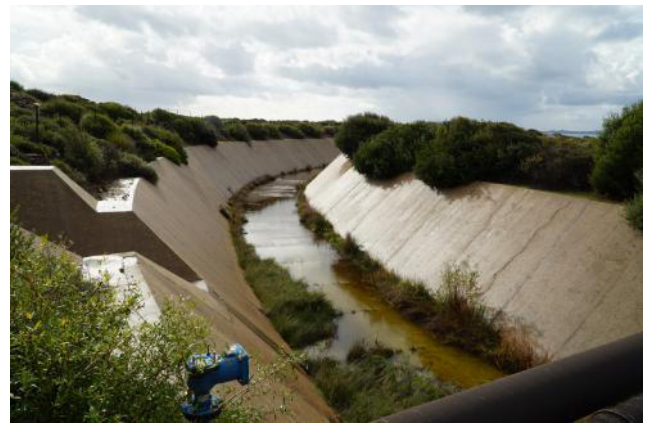
Foto 26 – Particolare delle acque all'interno del canale di guardia.
