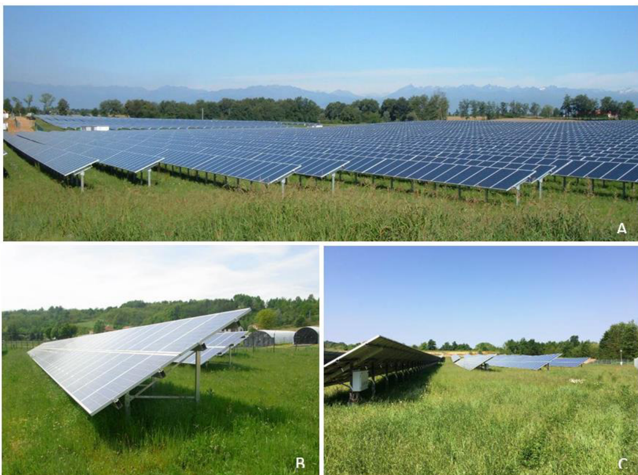
Figura 85. Immagini di grandi impianti fotovoltaici a terra (scattate dagli scriventi) riferite a progetti realizzati (anche con tecnologie differenti) che forniscono evidenza oggettiva dell'effetto non limitante dell'ombreggiamento generato per l'attività fotosintetica. A) Impianto FV "Ternavasso" – 7,5 MWp, Poirino (TO); B) Impianto FV "Cortiglione Green" – 0,8 MWp, Cortiglione (AT); C) Impianto FV "Sulpiano Cross" – 2,5 MWp, Montà (CN).
