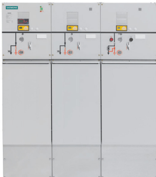
Figura 12 – Vista frontale quadro di protezione in alta tensione della cabina di trasformazione
