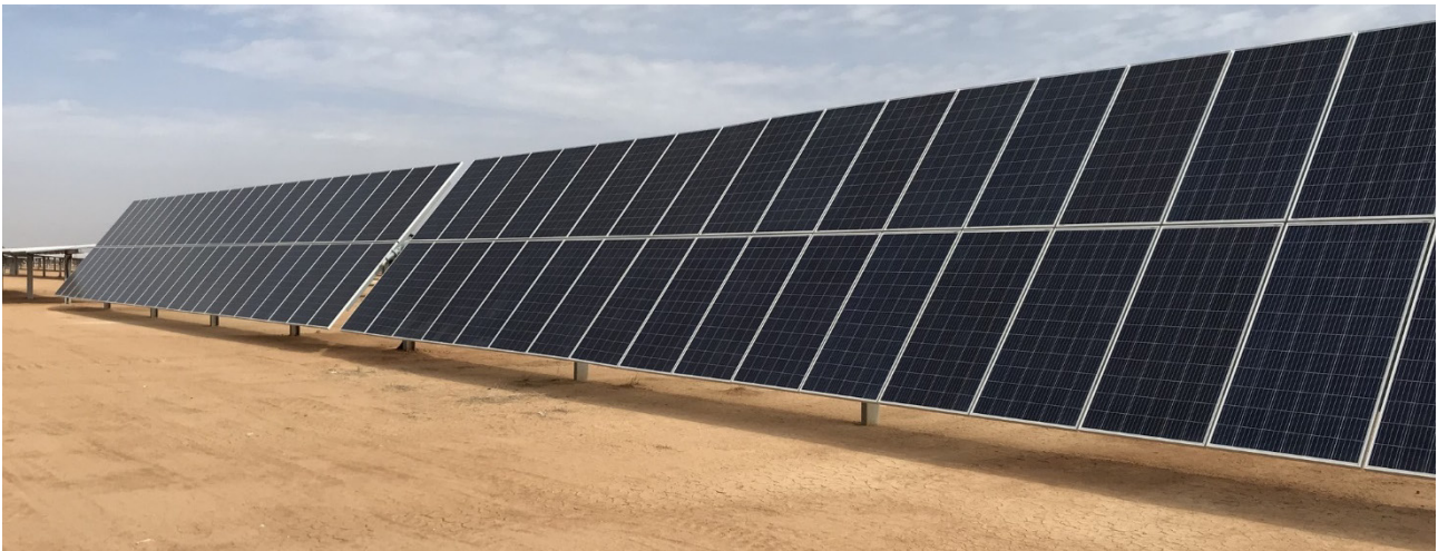
Figura 20 - Inseguitore monoassiale vista frontale
