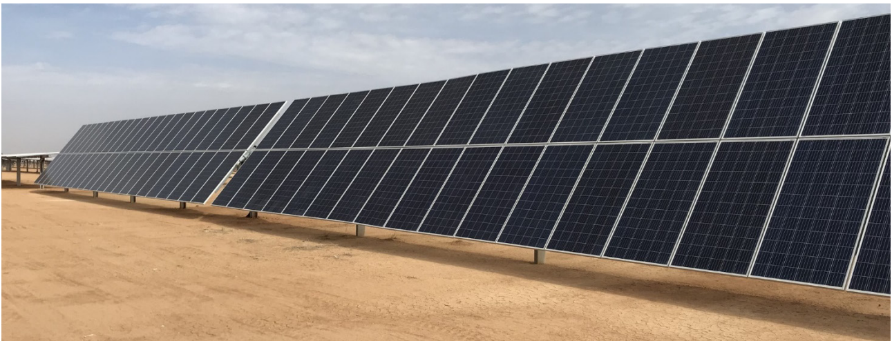
Figura 19 - Inseguitore monoassiale vista frontale
