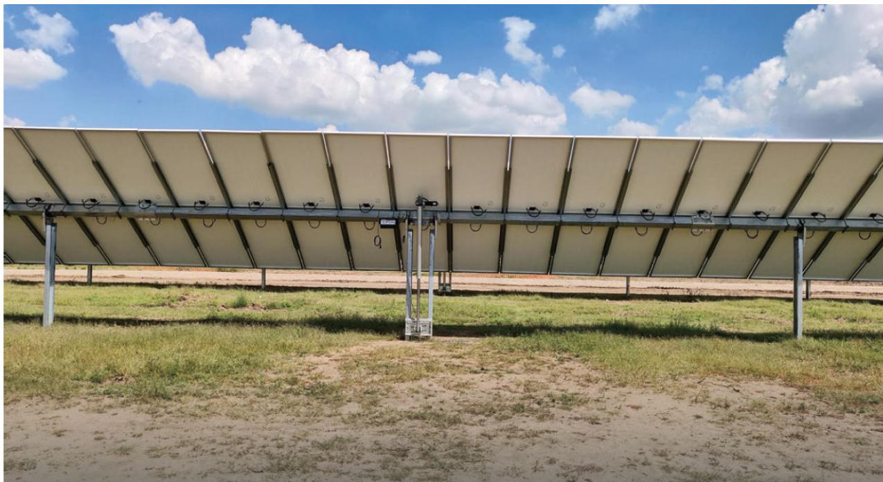
Figura 20 - Inseguitore monassiale vista posteriore
