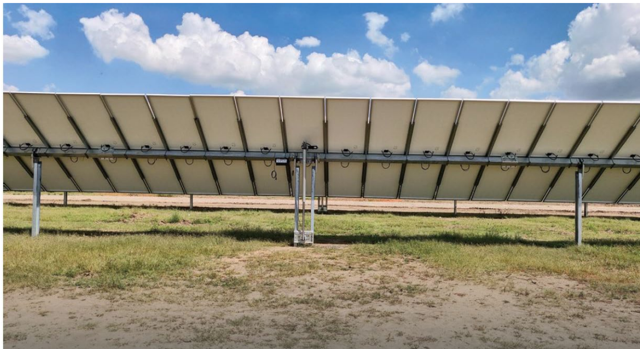
Figura 22 - Inseguitore monassiale vista posteriore
