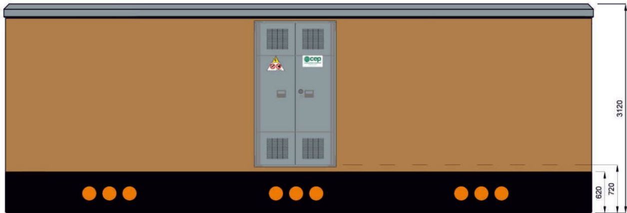
Figura 23 - Cabina elettrica monoblocco prefabbricata - Cabina elettrica generale di impianto
