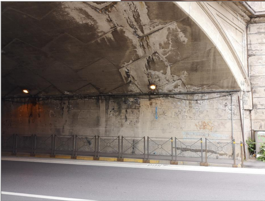
Figura 12 – Ponte ferroviario esistente su Corso XXVII Marzo/ via Lomellina: ammaloramenti
