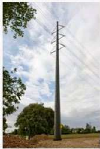
Foto 3.3 - Sostegno tubolare doppia terna
